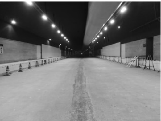
图 16 港珠澳大桥隧道照明效果实拍
